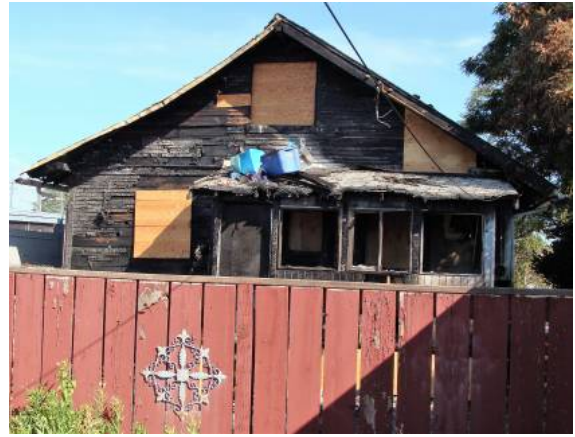
3810 N. 27th St., rear fire damage, 08/2019
